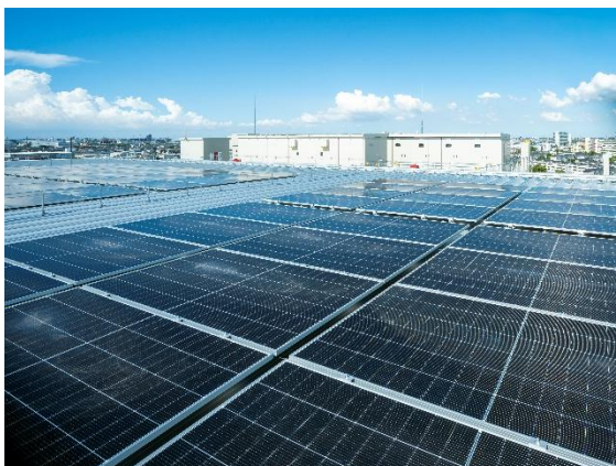
▲太陽光パネル（本物件屋上）
