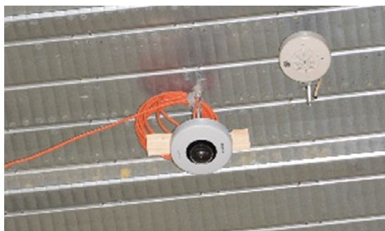
▲天井に設置した解析用カメラ（右の写真赤枠）
