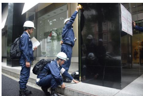
建物危険度判定
