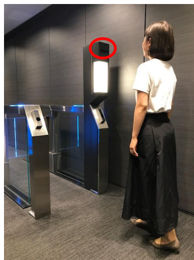
▲設置した顔認証ゲート（赤囲み部分）
