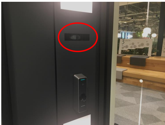
▲設置した顔認証ゲート（赤囲み部分）
