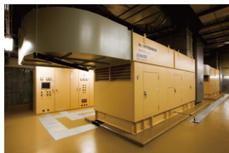
非常用発電機
