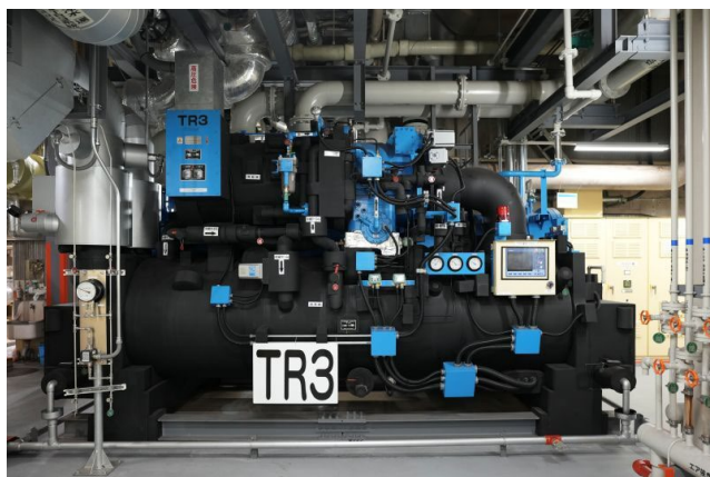
大手町ビルサブプラントの自動化対象冷凍機の1台
