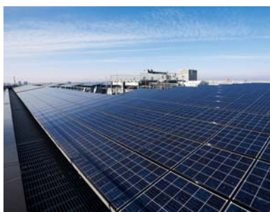
<屋上太陽光パネル>
